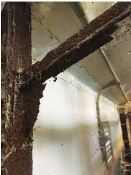
Cette structure d'acier dans un bâtiment porcin est fortement corrodée et est sur le point de s'affaisser.
