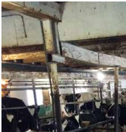
Cette image illustre très bien des poutres défailtantes.
